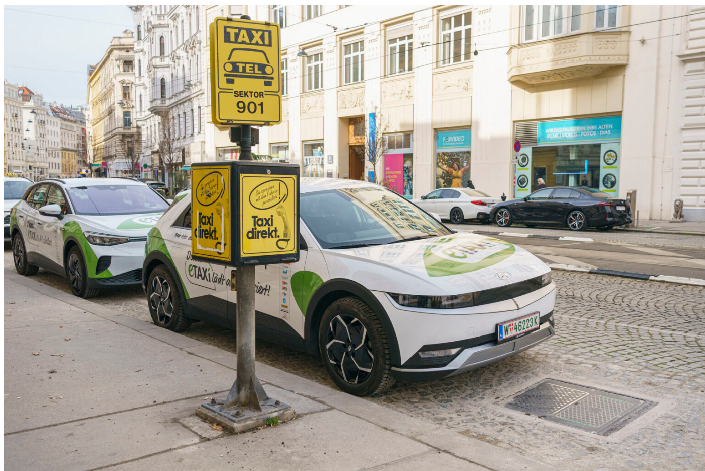
Automatische E-Ladestation für E-Taxis am Standplatz Porzellangasse. Foto (c) Wien Energie/ FOTObyHOFER
